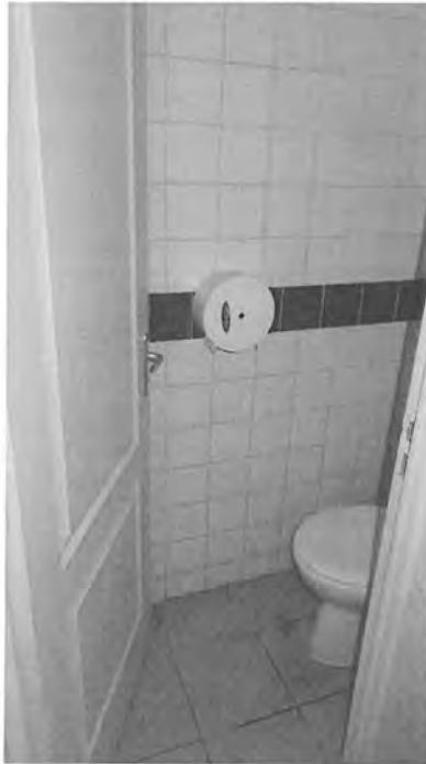
La cuvette des wc est souillée, et la chasse d'eau est dépourvue de son couvercle.
